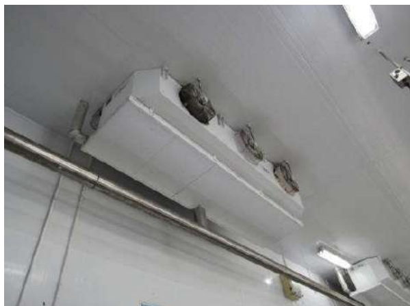
NR 999 - EVAPORADOR SETOR DESOSSA COOLING FREEZING
