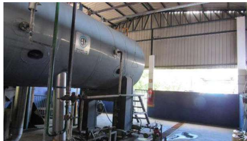
CALDEIRA (ÁREA INDUSTRIAL) Aspecto Geral
