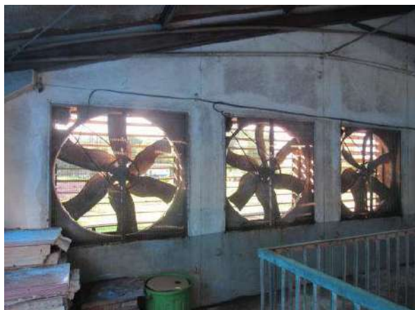
NR 999 - 6 VENTILADORES Ø 1 M COM MOTOR POT. 1 CV
