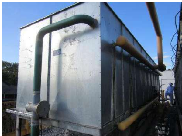
NR 999 - CONDENSADOR EVAPORATIVO COOLING FREEZING
