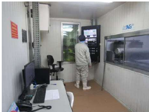
NR 999 - TÚNEL DE CONGELAMENTO COOLING FREEZING
