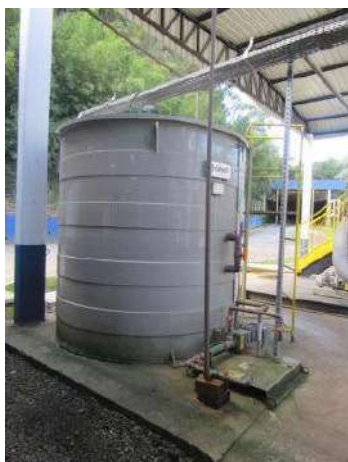
NR 999 - TANQUE CAP. 3000 L COM BOMBA GRATT
