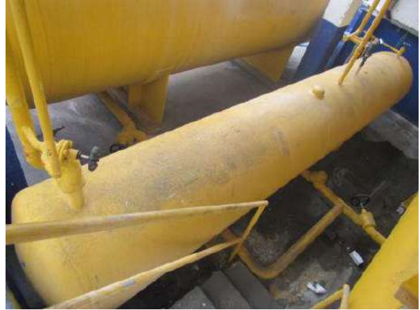
NR 999 - RESERVATÓRIO DE AMÔNIA CAP. 2 M 3
