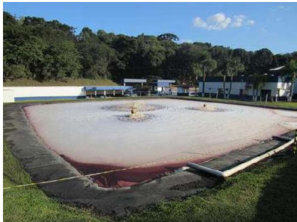
NR 999 - 3 AERADORES DA LAGOA DA ETE
