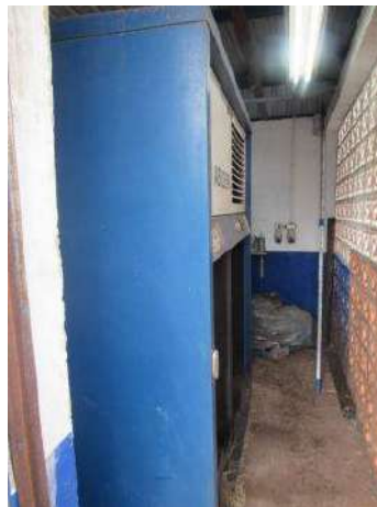
NR 999 - SOPRADOR COM MOTOR POT. 75 HP LAGOA 3 AERZEN DO BRASIL
