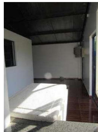
LABORATÓRIO Aspecto Interno
