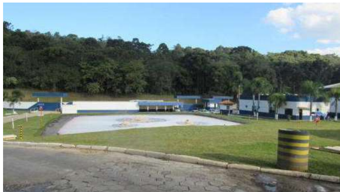
LAGOA DE TRATAMENTO COM LONA Aspecto Geral
