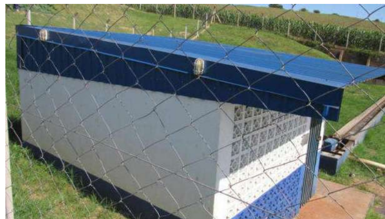
LAGOA DE TRATAMENTO AERÓBIA Aspecto Externo
