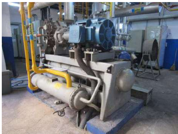
NR 999 - COMPRESSOR DE REFRIGERAÇÃO YORK
