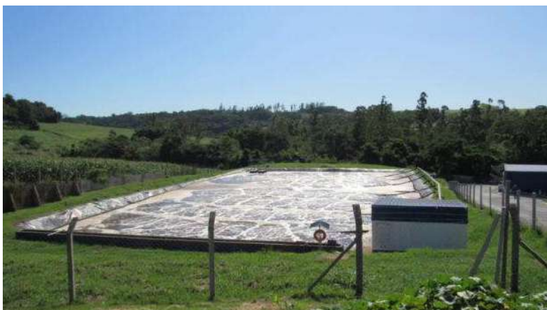
LAGOA DE TRATAMENTO AERÓBIA Aspecto Geral
