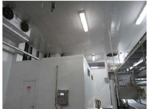
NR 999 - EVAPORADOR EMBALAGEM SECUNDÁRIA COOLING FREEZING
