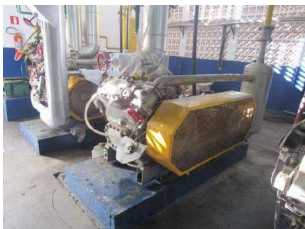
NR 999 - COMPRESSOR DE REFRIGERAÇÃO SABROE
