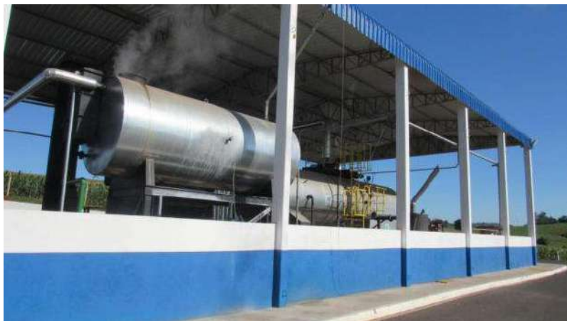
CALDEIRA (ÁREA FARINHA) Aspecto Geral
