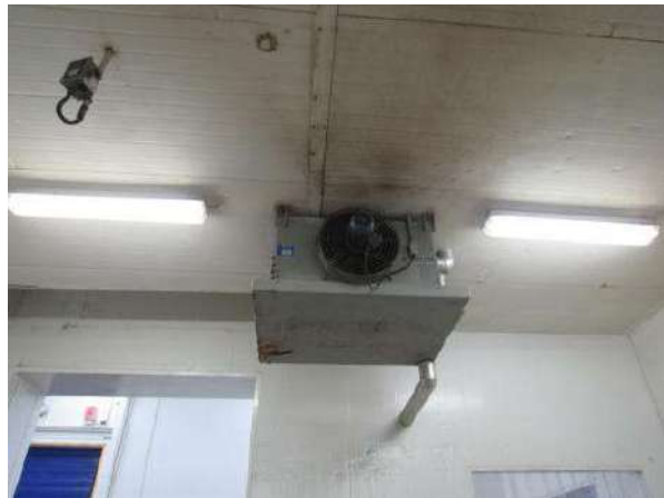
NR 999 - DESUMIDIFICADOR ANTE CÂMARA ESTOCAGEM ENTRADA FROST FRIO
