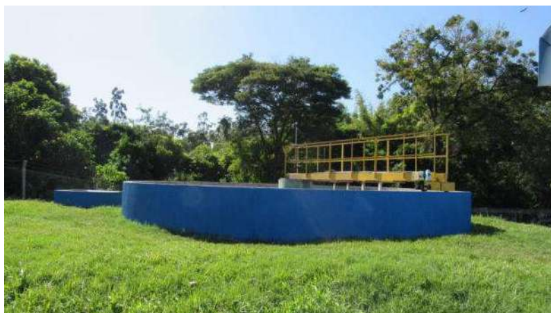
DECATADOR E POÇO ARTESIANO Aspecto Geral
