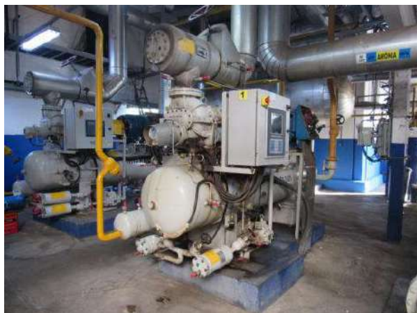
NR 999 - COMPRESSOR DE REFRIGERAÇÃO CAP. 838900 KCAL/H MAYEKAWA
