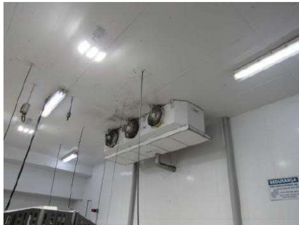
NR 999 - EVAPORADOR SETOR DESOSSA COOLING FREEZING
