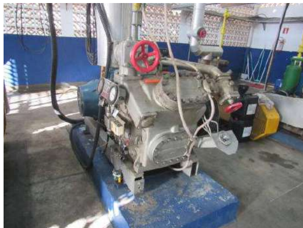
NR 999 - COMPRESSOR DE REFRIGERAÇÃO SABROE
