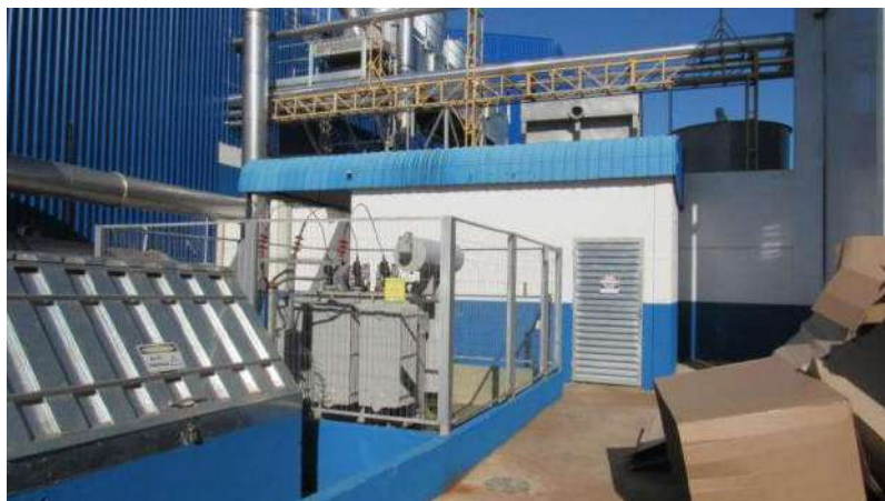
SUBESTAÇÃO DE ENERGIA ELÉTRICA Aspecto Geral
