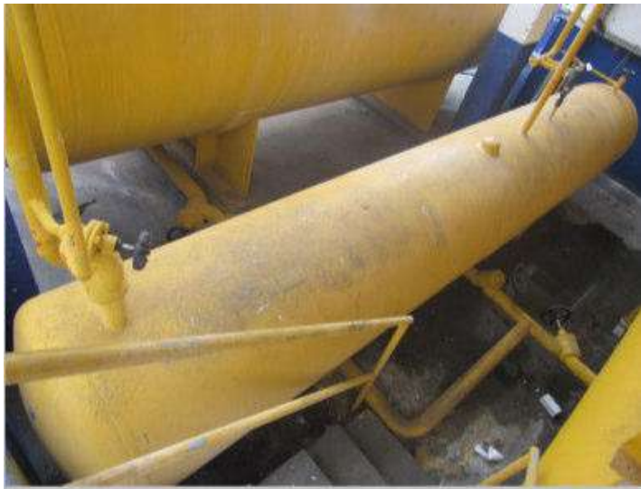
- RESERVATÓRIO DE AMÔNIA CAP. 2 M³
