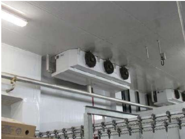
NR 999 - EVAPORADOR EMBALAGEM SECUNDÁRIA COOLING FREEZING
