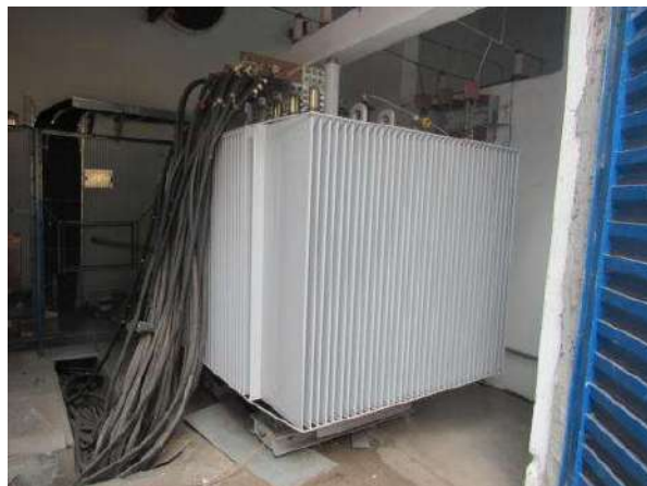
NR 999 - TRANSFORMADOR CAP. 3000 KVA WEG 13362768
