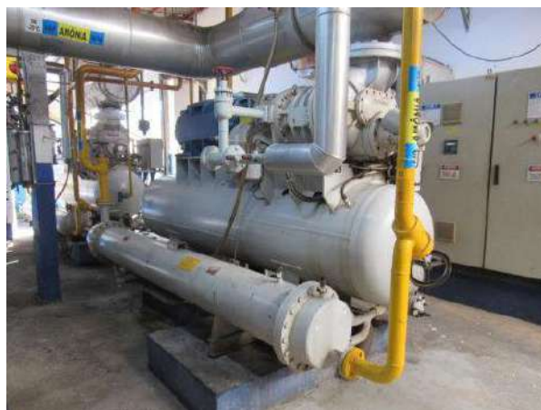
NR 999 - COMPRESSOR DE REFRIGERAÇÃO CAP. 449900 KCAL/H MYCOM
