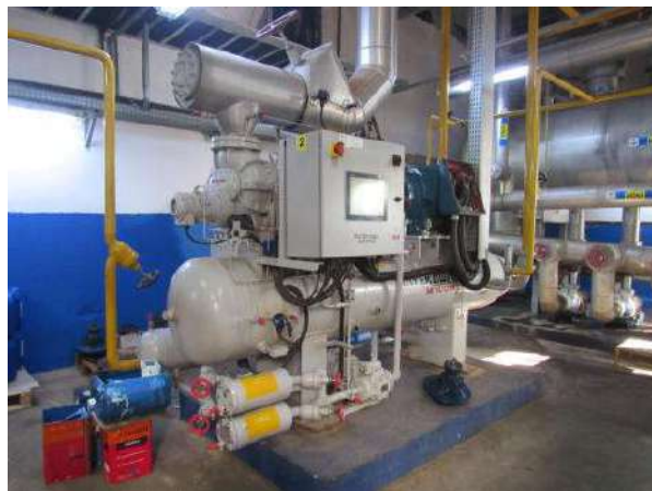
NR 999 - COMPRESSOR DE REFRIGERAÇÃO CAP. 837000 KCAL/H MAYEKAWA
