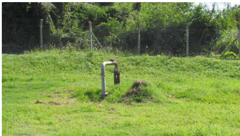
DECATADOR E POÇO ARTESIANO Aspecto Geral
