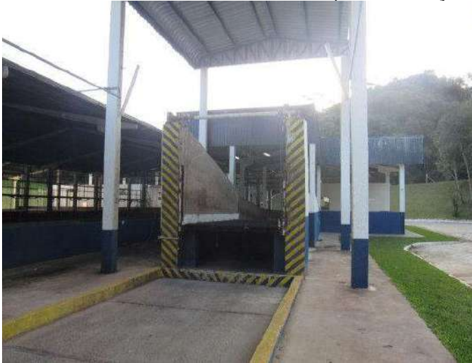
RAMPA DE DESCARREGAMENTO ELÉTRICA (LOCALIZAÇÃO: IBIPORÃ) R$ 70.000,00
