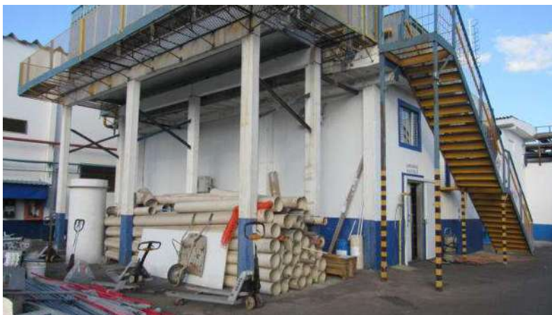
TORRE DE RESFRIAMENTO Aspecto Externo
