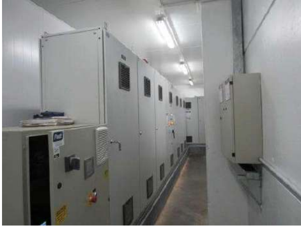
NR 999 - INSTALAÇÃO ELÉTRICA DE FORÇA FÁBRICA DE FARINHA THOR
