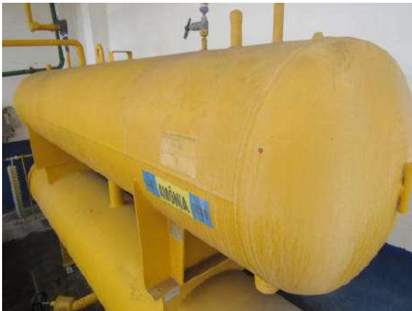
NR 999 - RESERVATÓRIO DE AMÔNIA CAP. 2 M 3 SEIKAN REFRIGERAÇÃO
