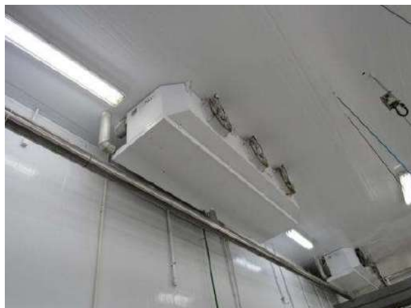
NR 999 - EVAPORADOR SETOR DESOSSA COOLING FREEZING
