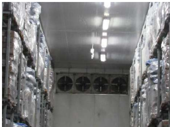
NR 999 - 2 EVAPORADORES COM 4 VENTILADORES DA CÂMARIA FRIA DE ESTOCAGEM - 4 (ESTOCAGEM VELHA)
