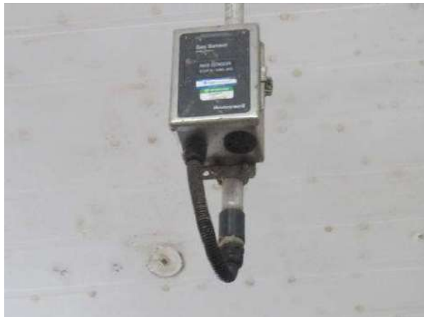
NR 999 - 40 SENSORES DE PRESENÇA DE AMÔNIA HONEYWELL
