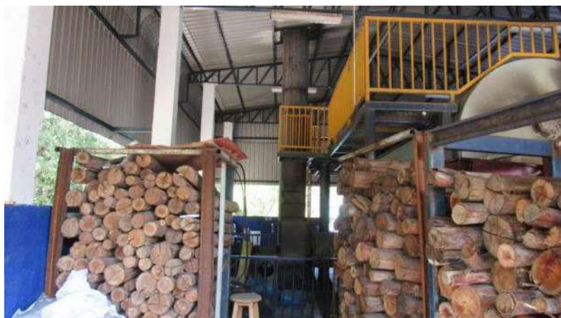
CALDEIRA (ÁREA INDUSTRIAL) Aspecto Geral
