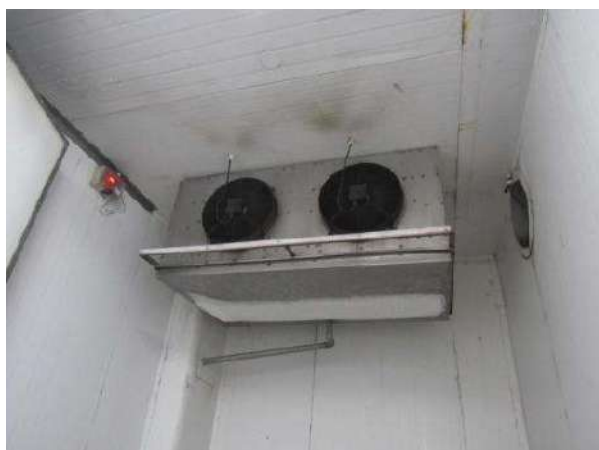
NR 999 - EVAPORADOR COM 2 VENTILADORES CORREDOR ENTRADA ABATE NICOLA
