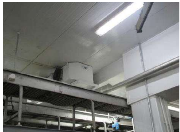
NR 999 - EVAPORADOR EMBALAGEM SECUNDÁRIA COOLING FREEZING
