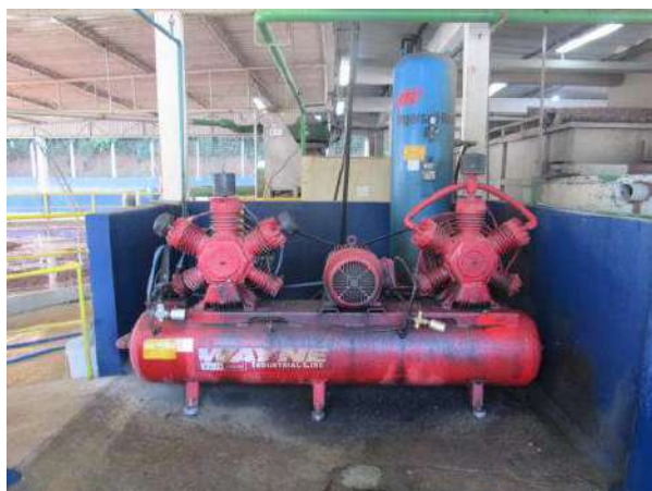
NR 999 - COMPRESSOR DE AR PISTÃO 2 CABEÇOTES 5 CLINDROS WAYNE
