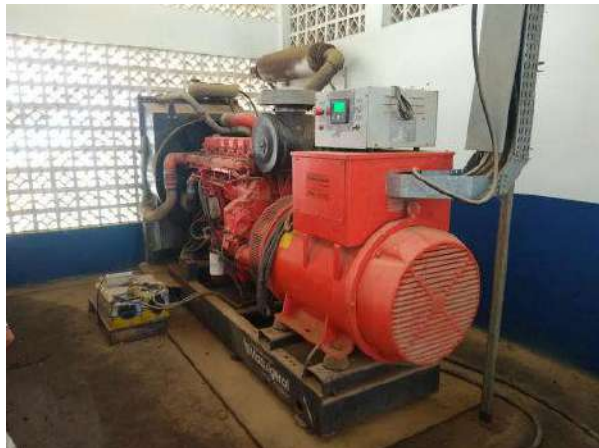
NR 999 - GRUPO GERADOR CAP. 500 KVA MAQUIGERAL
