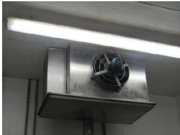
NR 999 - EVAPORADOR COM 1 VENTILADOR SALA DE INJEÇÃO DEFUMADOS
