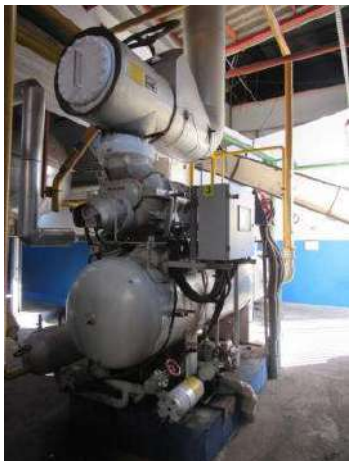
NR 999 - COMPRESSOR DE REFRIGERAÇÃO CAP. 611100 KCAL/H MAYEKAWA
