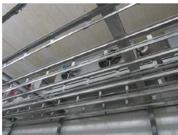
NR 999 - 1 EVAPORADOR COM 3 VENTILADORES + 3 EVAPORADORES COM 2 VENTILADORES DA CÂMARA FRIA DE CARC
