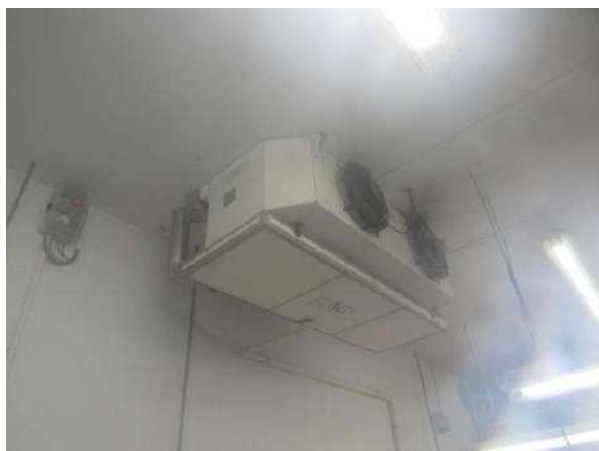
NR 999 - EVAPORADOR COM 2 VENTILADORES SALA MIÚDOS, PAPADA E CABEÇA COOLING FREEZING
