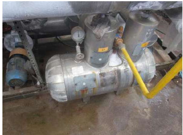
NR 999 - SEPARADOR DE LÍQUIDO CAP. 7,29 M 3 E ACUMULADOR DE ÓLEO CAP. 0,05 M 3 COOLING FREEZING
