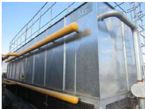
NR 999 - CONDENSADOR EVAPORATIVO COOLING FREEZING
