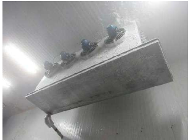
NR 999 - EVAPORADOR COM 4 VENTILADORES DO SETOR DE ESTOCAGEM
