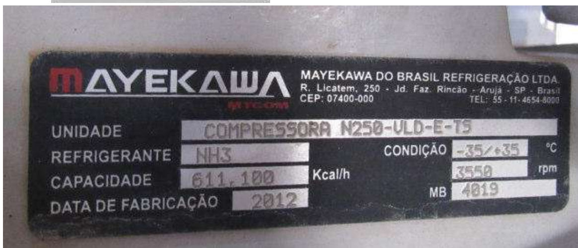
- COMPRESSOR DE REFRIGERAÇÃO CAP. 837000 KCAL/H
