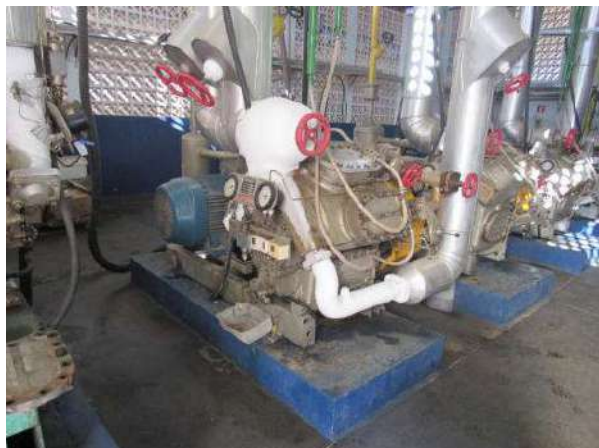
NR 999 - COMPRESSOR DE REFRIGERAÇÃO SABROE
