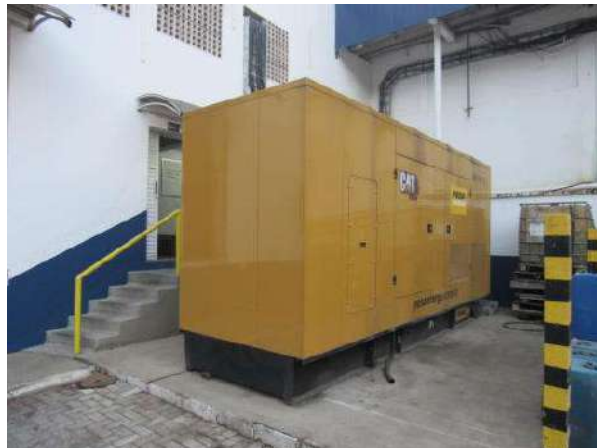
NR 999 - GRUPO GERADOR CAP. 750 KVA CATERPILLAR
