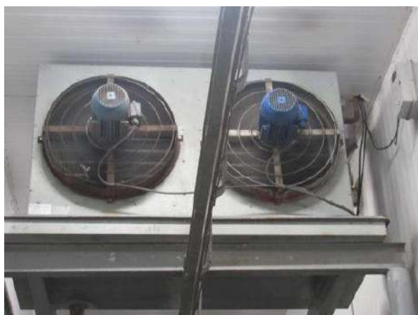
NR 999 - DESUMIDIFICADOR COM 2 VENTILADORES DO CORREDOR DE ENTRADA NICOLA
