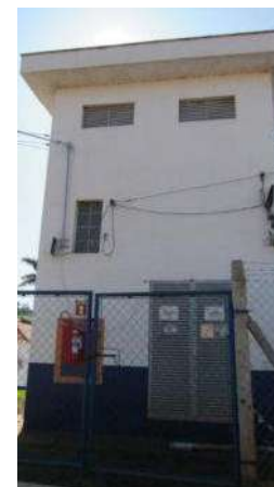
CABINE DE FORÇA Aspecto Geral
