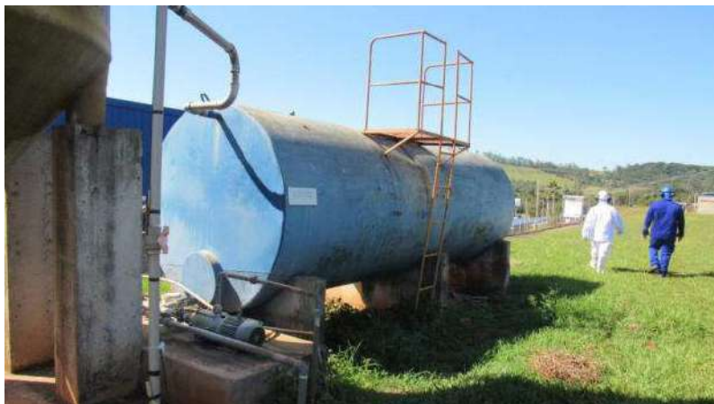
RESERVATÓRIO DE FIBRA Aspecto Geral
