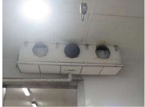
NR 999 - EVAPORADOR EMBALAGEM SECUNDÁRIA COOLING FREEZING
