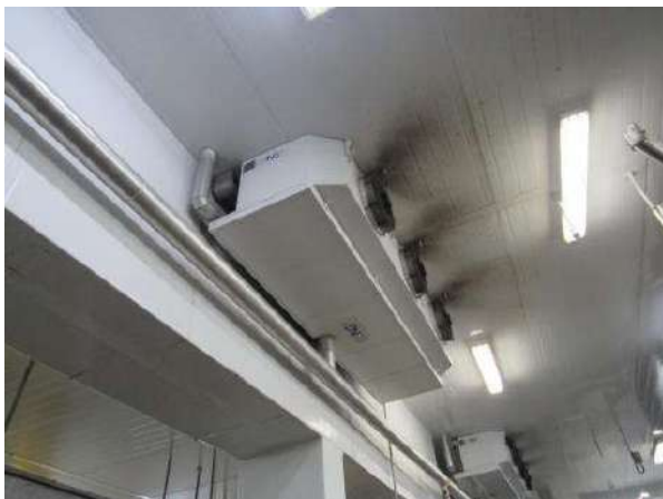
NR 999 - EVAPORADOR EMBALAGEM SECUNDÁRIA COOLING FREEZING
