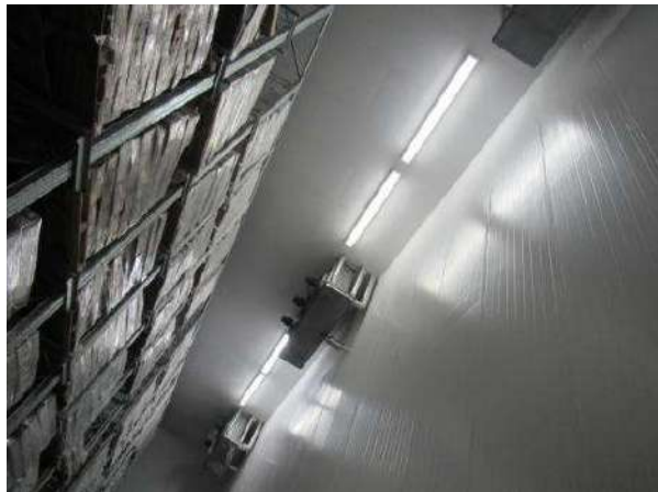
NR 999 - 6 EVAPORADORES COM 3 VENTILADORES DA CÂMARA FRIA DE ESTOCAGEM - 5 (ESTOCAGEM NOVA)
