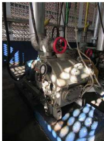
NR 999 - COMPRESSOR DE REFRIGERAÇÃO SABROE
