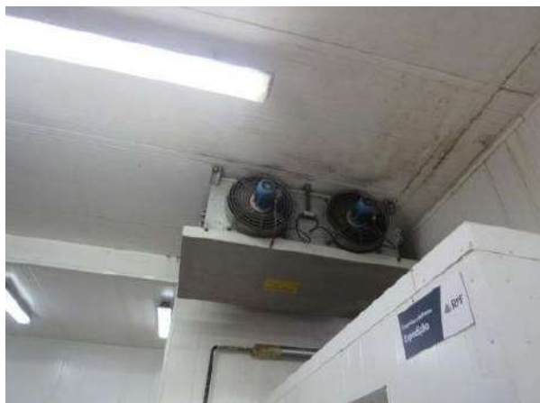
NR 999 - DESUMIDIFICADOR EXPEDIÇÃO DE CONGELADOS FROST FRIO
