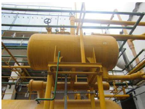
NR 999 - RESERVATÓRIO DE AMÔNIA CAP. 1,053 M³
