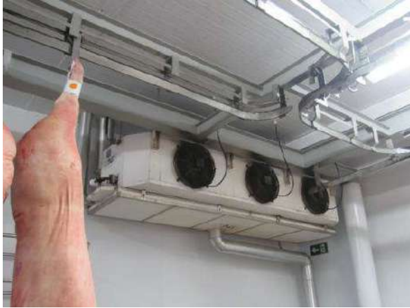
NR 999 - EVAPORADOR CORREDOR ENTRADA DESOSSA COOLING FREEZING
