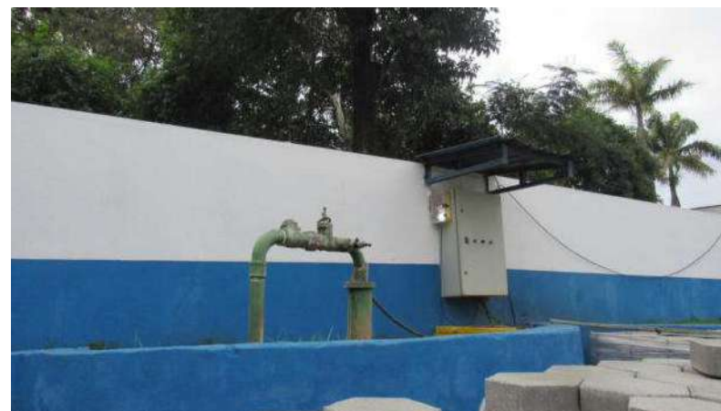
POÇO ARTESIANO 2 Aspecto Geral
