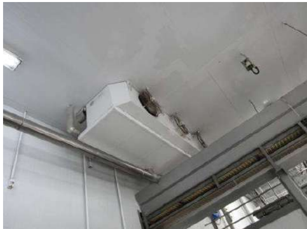
NR 999 - EVAPORADOR SETOR DESOSSA COOLING FREEZING
