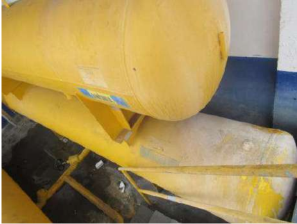
NR 999 - RESERVATÓRIO DE AMÔNIA CAP. 2 M 3
