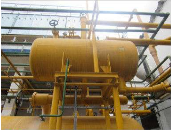
- RESERVATÓRIO DE AMÔNIA CAP. 1,053 M³
