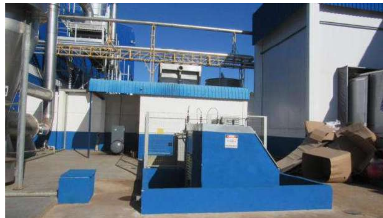
SUBESTAÇÃO DE ENERGIA ELÉTRICA Aspecto Geral
