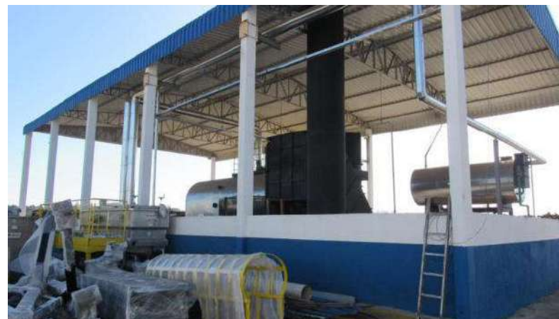
CALDEIRA (ÁREA FARINHA) Aspecto Geral
